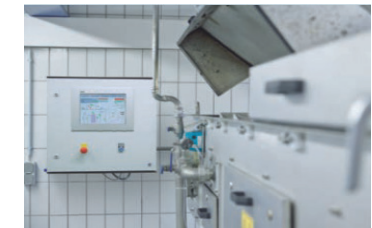
Aquisição de dados de energia para operação com eficiência energética
