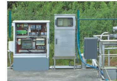
Armazenamento confiável de dados operacionais
