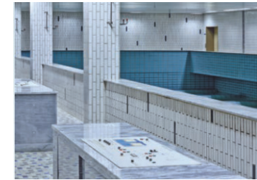
Controle modular de estágios de filtração
