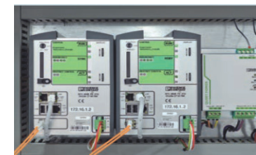
Controlador redundante no estágio 2 de filtração
