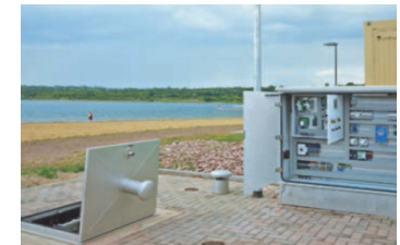
Tecnologia de controle remoto para estações de bombeamento descentralizadas
